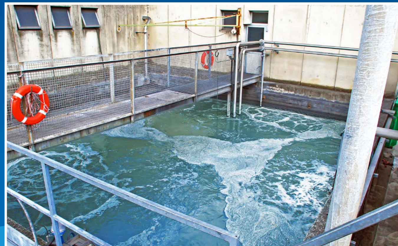
RAFFIGURAZIONE VASCA DI OSSIDAZIONE BIOLOGICA DA 400 M 3 A SERVIZIO IMPIANTO MBR ATTREZZATA CON N°4 STORMIX® MOD. 4HP FUNZIONANTI DAL 2017. INSTALLAZIONE PRESSO DITTA FABER S.P.A. DI CASTELFRANCO VENETO (TV)
